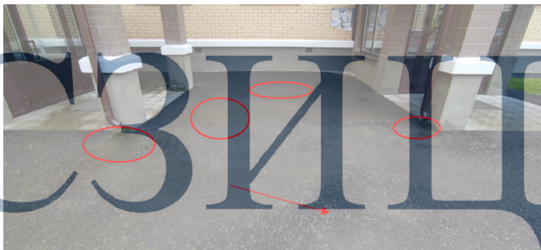
Фото 3.38 Фотофиксация заполнителя асфальтобетонного покрытия, участки выкрашивания, линзы воды с отражением кирпичной кладки
